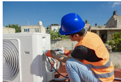
CONDIZIONAMENTO E RISCALDAMENTO
